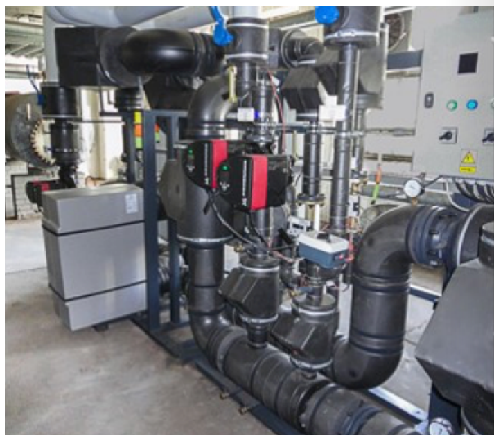
Рис. 26: Модернизированная станция теплового ввода; централизованное теплоснабжение. Источник: ВВР
