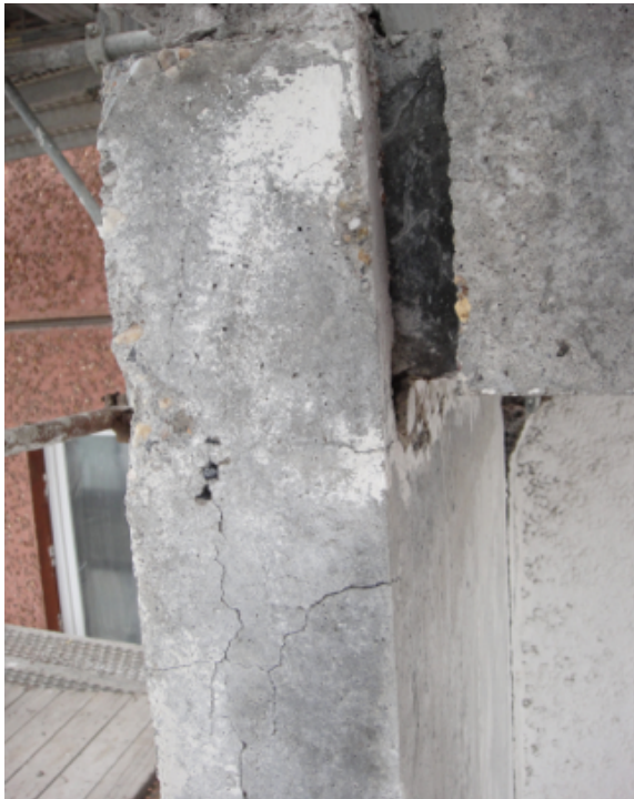
Рис. 10: Образование сетчатых трещин в боковой стене лоджии дома серии WBS 70-11 в результате щёлочно-силикатной реакции. Источник: ВВР
