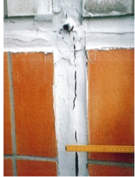
Рис. 16: Рассохшийся и растрескавшийся стыковой герметик на здании серии QP. Источник: ВВР
