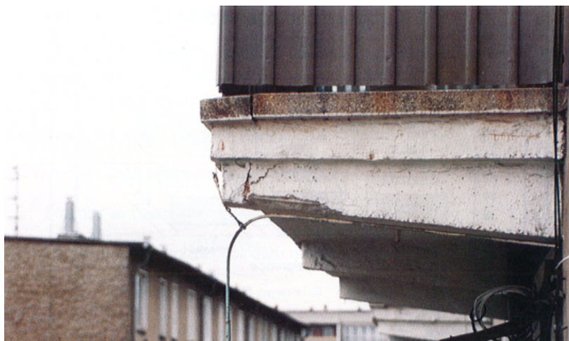
Рис. 12: Сильная коррозия консоли плиты лоджии дома серии P2-11. Источник: ВВР
