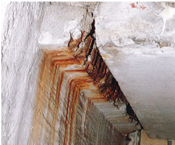
Рис. 14: Дефект консоли балконной панели дома серии Q3A. Источник: ВВР
