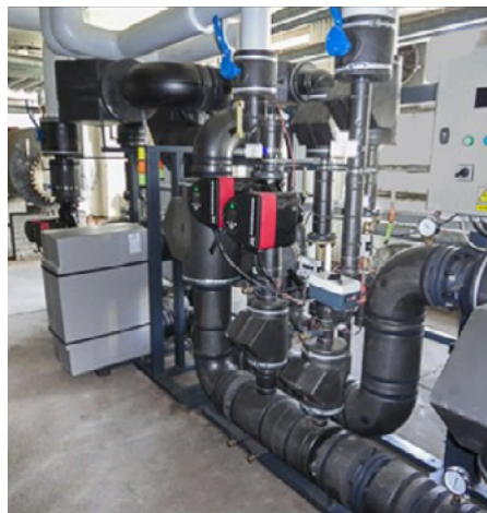
Рис. 43: Современная и энергоэффективная станция подключения здания к сети центрального теплоснабжения. Источник: ВВР
