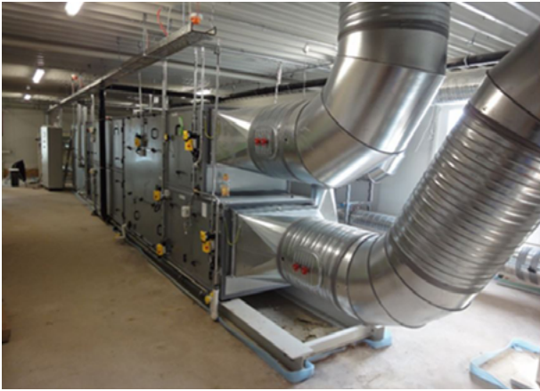
Рис. 90 : Венткамера с рекуператором. МКД Binzengrün, Freiburg.
