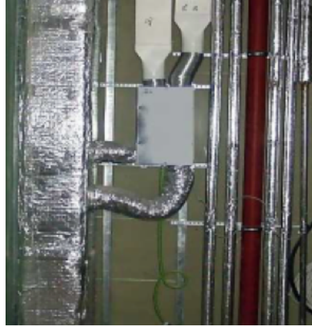
Рис. 30: Теплообменник в сборке; санитарная шахта. Источник: ВВР
