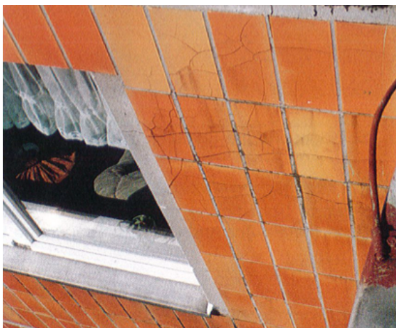
Рис. 15: Значительно растрескавшаяся керамическая облицовка дома серии QP. Источник: ВВР
