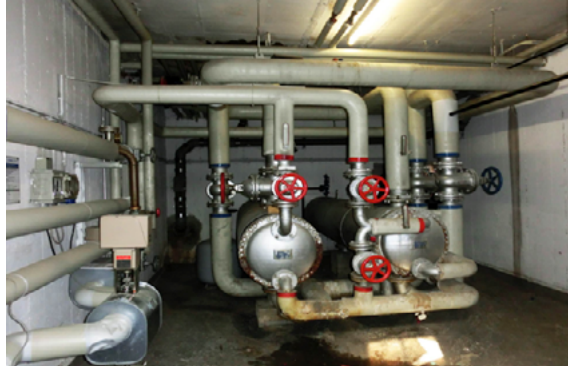
Рис. 18: Станция централизованного теплоснабжения с двумя трубчатыми теплообменниками для производства горячей воды. Источник: BWP
