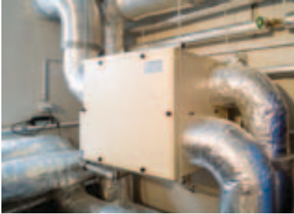
Abb. 58: Zu- und Abluftanlage mit Wärmerückgewinnung
