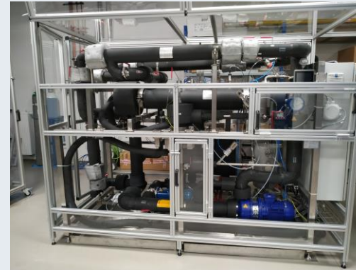
Membrananlage zur Gastrocknung
